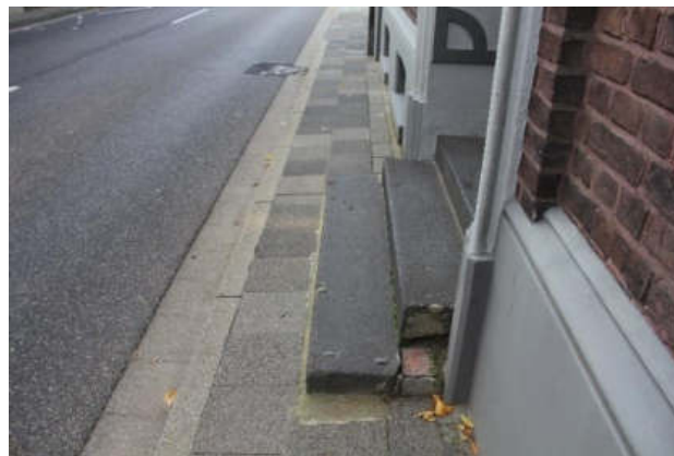
Abb. 108: Gefährliche Hindernisse auf den Gehwegen
